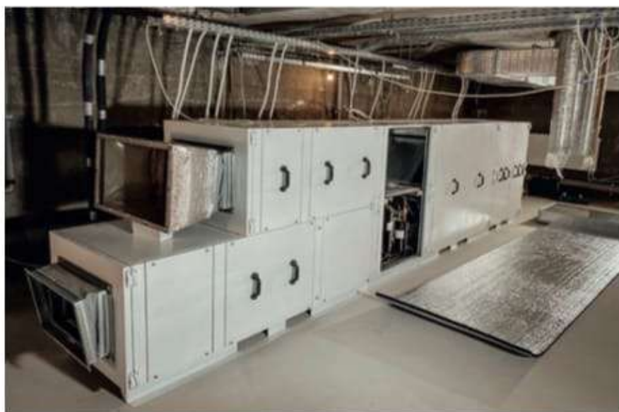
Приточно-вытяжная установка с осушителем
